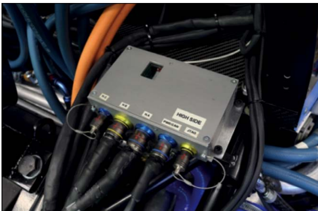
Bild 2. Die Power Distribution Unit verteilt die Niederspannungsversorgung und überwacht sicherheitskritische Systeme. (Bild: Segger)
